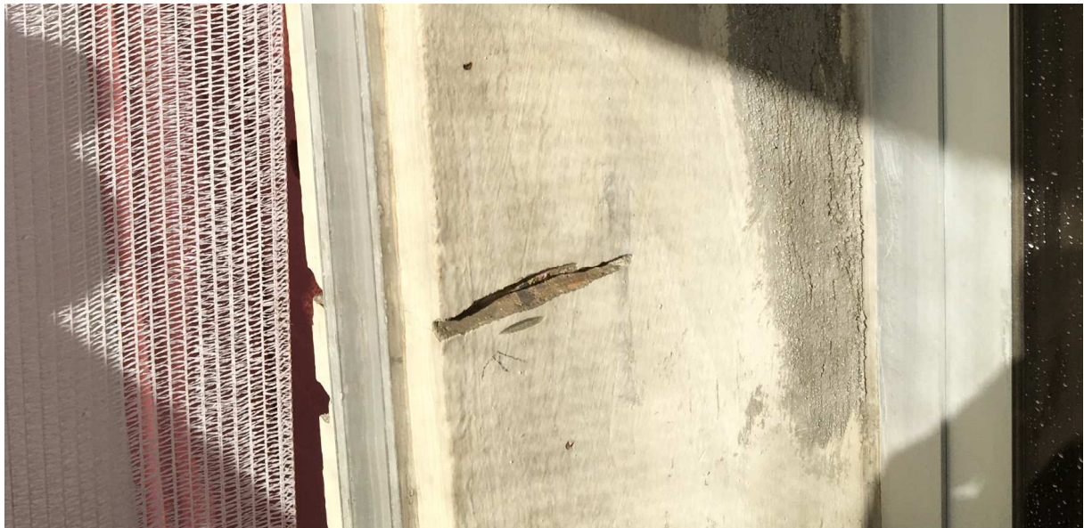
Figura 2.2 – Aberturas efetuadas para verificação do estado da armadura por baixo das fissuras transversais dos elementos verticais
