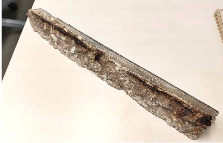
Figura 2.1 – Fragmento de betão removido de um elemento vertical da fachada sul do edifício de ampliação
