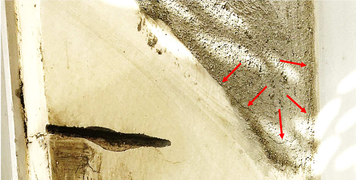
Figura 2.3 – Fissura no perímetro da zona reparada de um elemento vertical da fachada sul do edifício de ampliação
