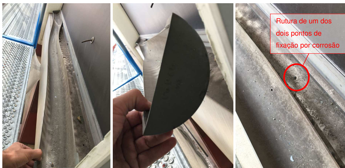
Figura 4.1 – Calha de retenção de água dos AVACs com rotura de um dos dois pontos de fixação
